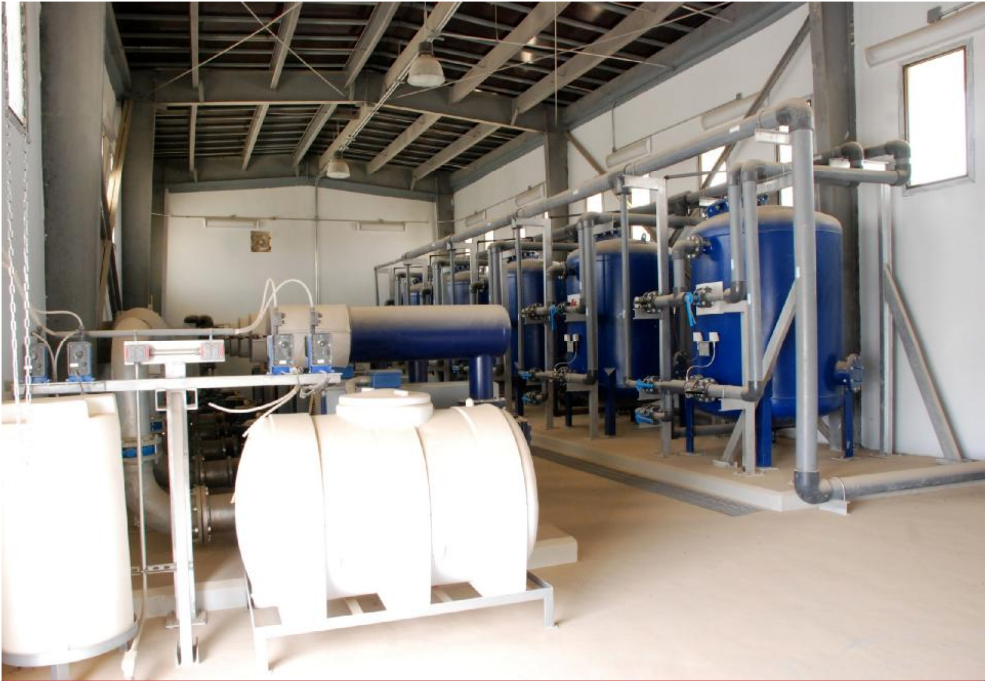
معدات محطة تنقية مياه الصرف الصحي
